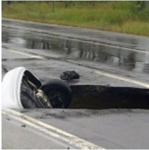
Canada : un « sinkhole » avale une voiture
