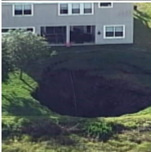
États-Unis : un trou terrestre avale une cour entière, arbres compris
